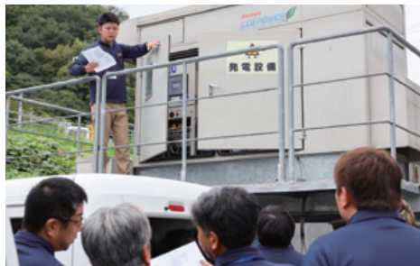
非常用発電設備の操作確認
